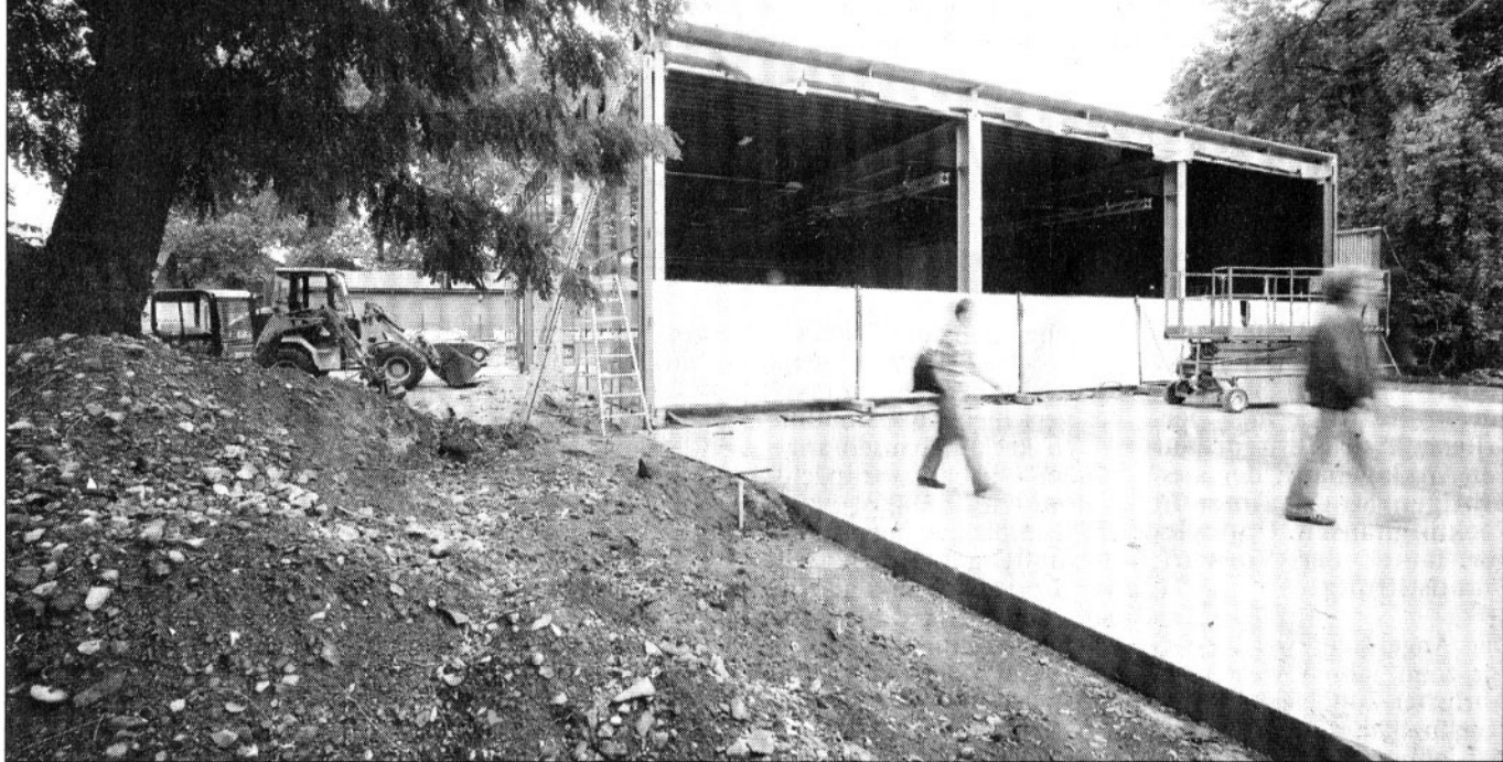
Die Bodenplatte zur Erweiterung des Paulaner Clubs ist schon gegossen. Nach der Fertigstellung sollen doppelt so viele Gäste Platz finden als bisher.
